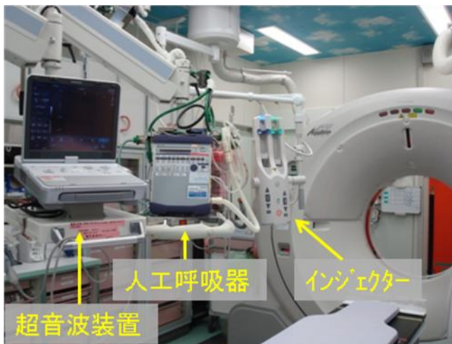
Fig. 3 天井から吊り下げた医療機器
