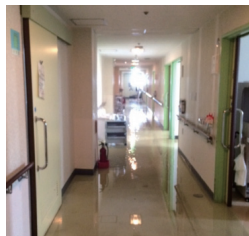
図 2 漏水した病棟(天井の電灯が床に反射)
