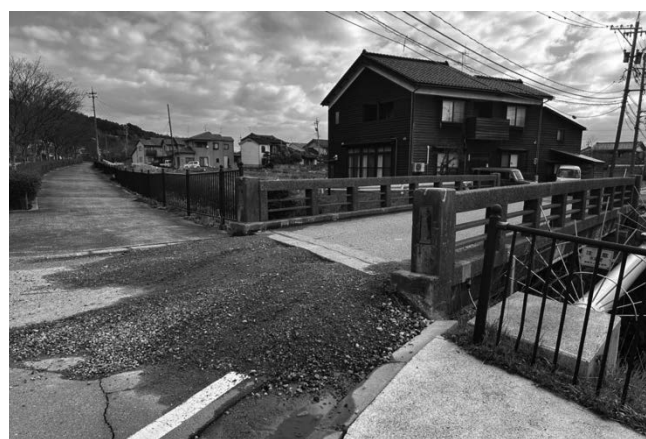
橋には段差が生じ応急修繕がされている
